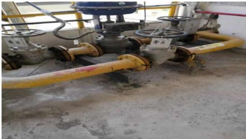
附件 8（中和浓缩二楼氨气管道阀门状态标识恢复正常）
