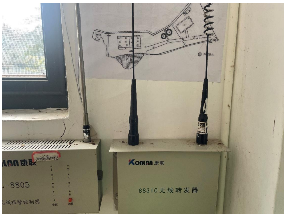
(4) 库房外电气箱盒外壳已规范接地, 未串接
