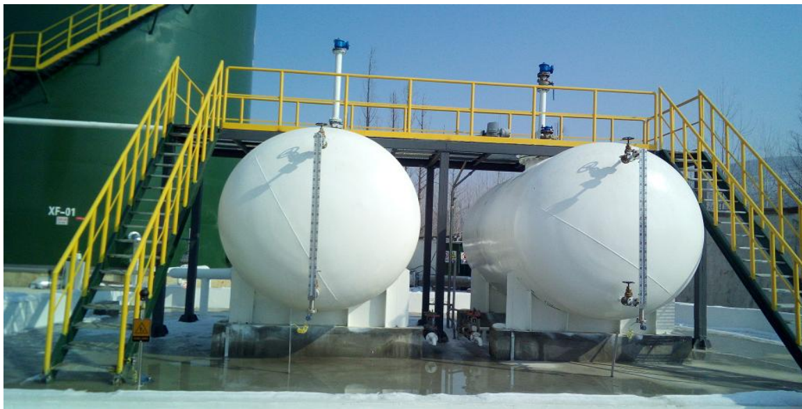
图 2.4-6 倒罐泵棚及扫仓罐
